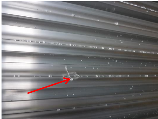
Foto 1: deze zaagresten tussen de latten zijn zeer storend voor voorbehandeling en eindresultaat.
