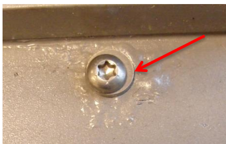
Foto: voorbeeld van galvanische corrosie omwille van een direct contact tussen 2 metalen.
